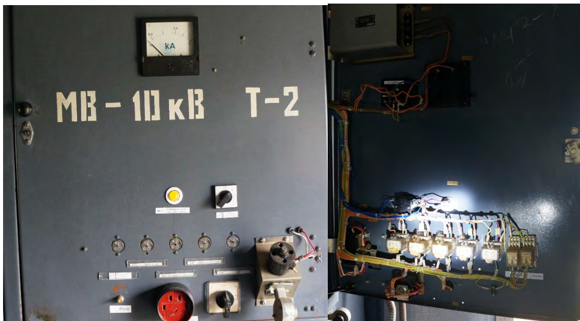
Рис. 1 Пример установки тумблера разрешения управления и реле в ячейке МВ-10 кВ Т-2
